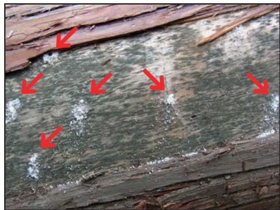
写真2 害虫（キクイムシ類）が材内に穿入した痕跡
